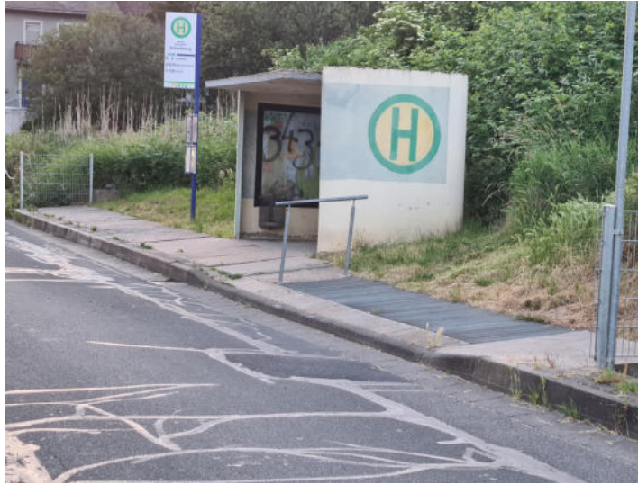
Die Bushaltestelle „Schacht“ in der Mühlstraße Fahrtrichtung Martinthal ist nicht behindertengerecht zugänglich.
